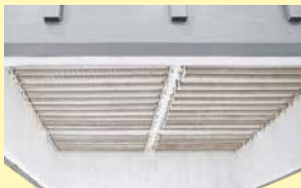
Elementos calefactores en la campana del horno
