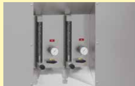
Sistema de inyección de gas automático
