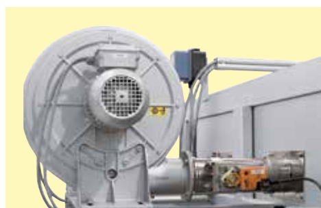
Ventiladores de refrigeración para favorecer el proceso de refrigeración
